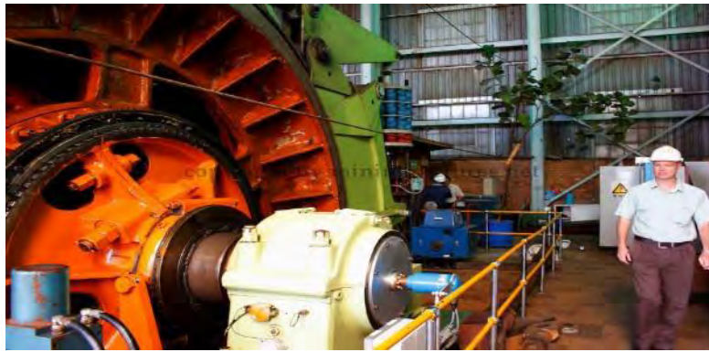
Figura 1.20. Cameră subterană și instalații ale mașinii de extracție, mină Africa de Sud
