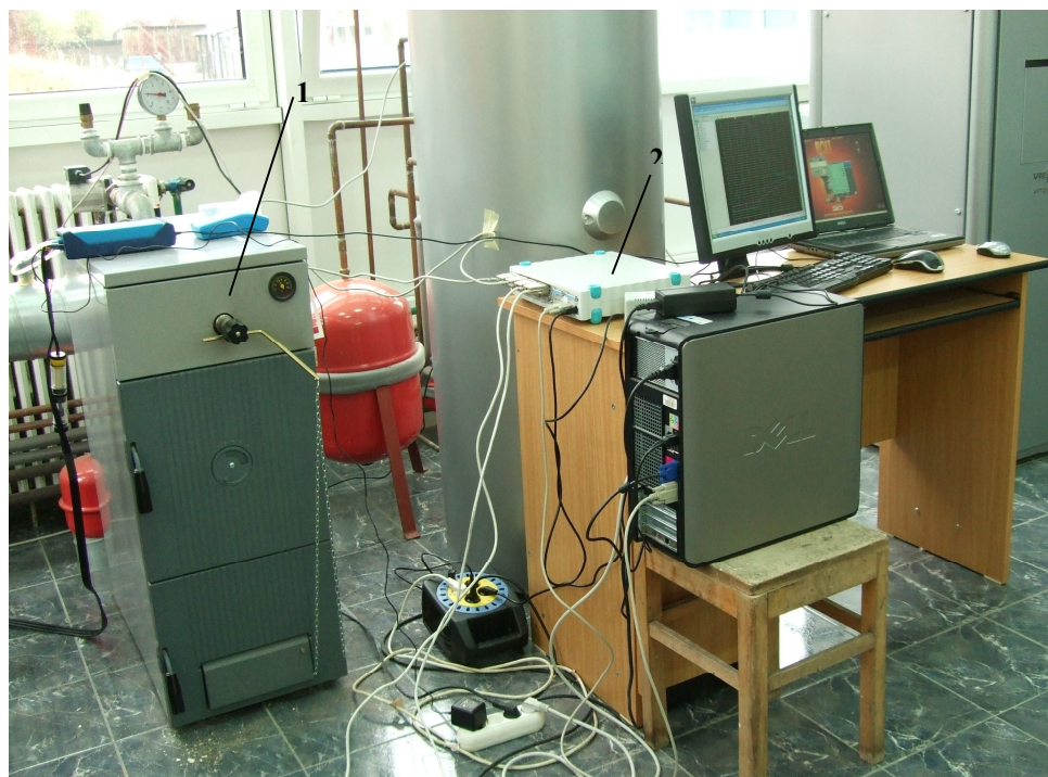
Figura 6.3. Stand generator de energie termică cu biomasă solidă: 1 – generator de energie termică; 2 – sistem monitorizare și achiziție date experimentale
