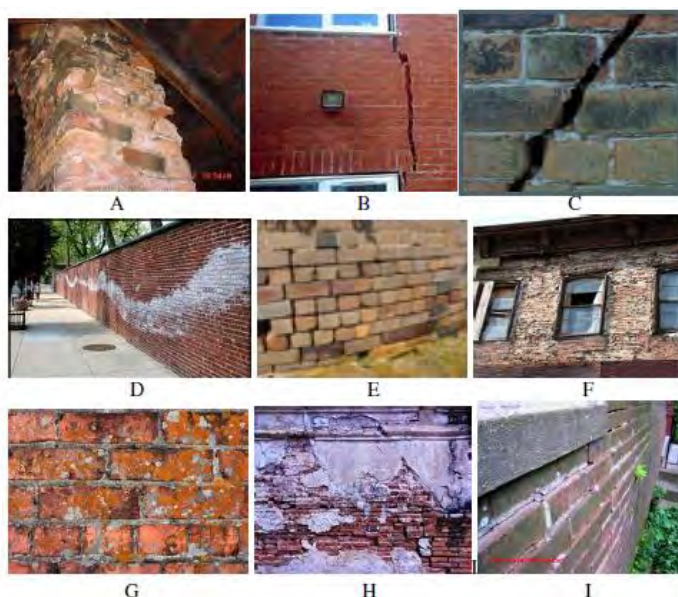
Fig. 3.44a Avarii întâlnite la zidării [26]
