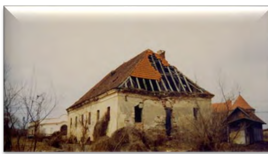
Fig. 2.37b Moara în stare avansată de degradare [138]
