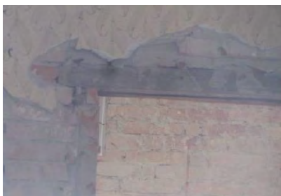
Fig. 5.6 Deteriorări în dreptul golului de ușă
