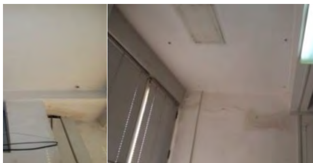
Fig. 5.33 Pete uscate din infiltrațiile de apă
