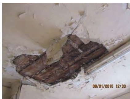
Fig. 5.9 Suprafața degradată la planșeul peste parter
