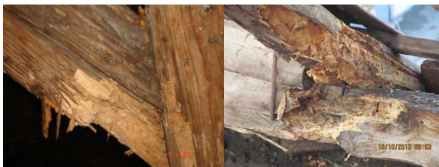
Fig. 5.10 Element al șarpantei deteriorat
