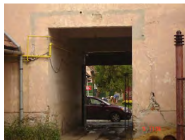
Fig. 5.7 Pereți la parter cu fisuri și crăpături
