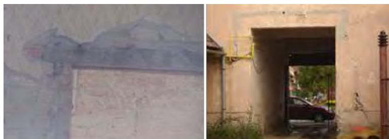
Fig. 5.15 Deteriorări în dreptul golului de ușă. Pereți la parter cu fisuri și crăpături
