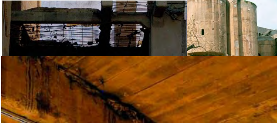
Fig. 2.29 Degradări ale elementelor structurale [128]
