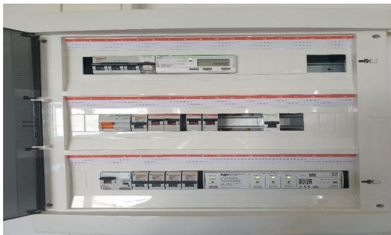
Figura. 4. Sistem de control Zumtobel Litecom de la Facultatea de Inginerie a instalațiilor
