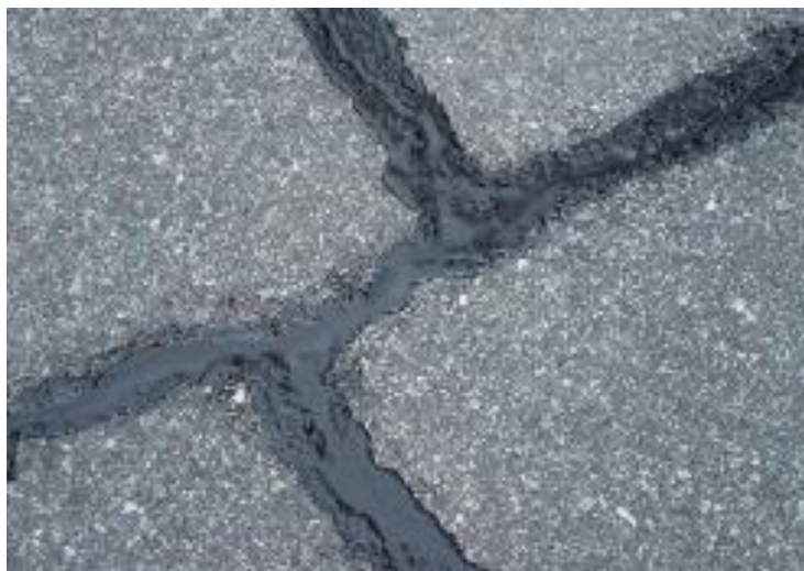
Fig.6 Rosturi colmate cu emulsie cationică
