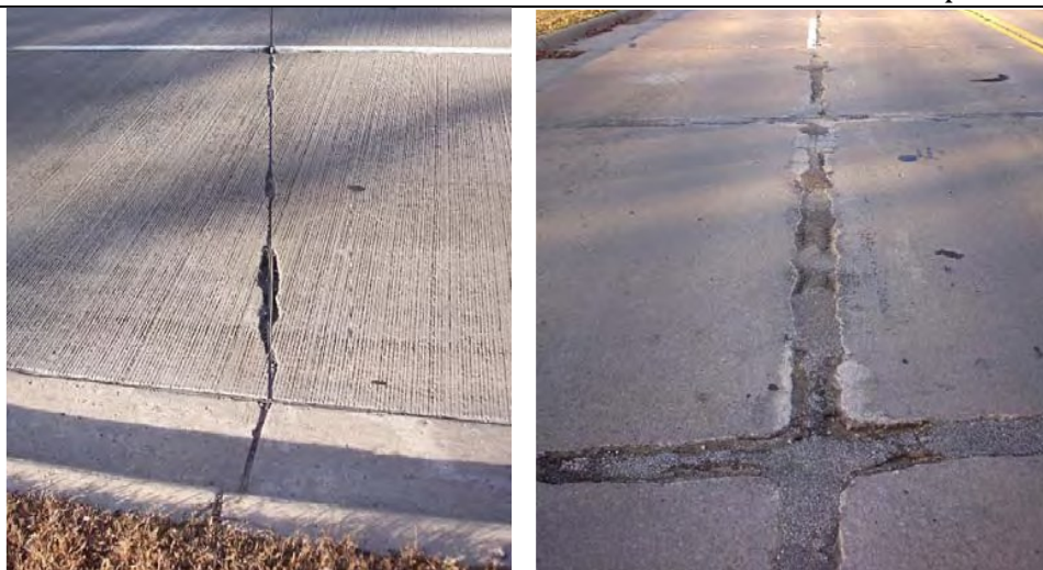
Figura 1-12. a) Degradare la șase ani de exploatare; b) Deteriorare după douăzeci și unu de ani de exploatare [71]
