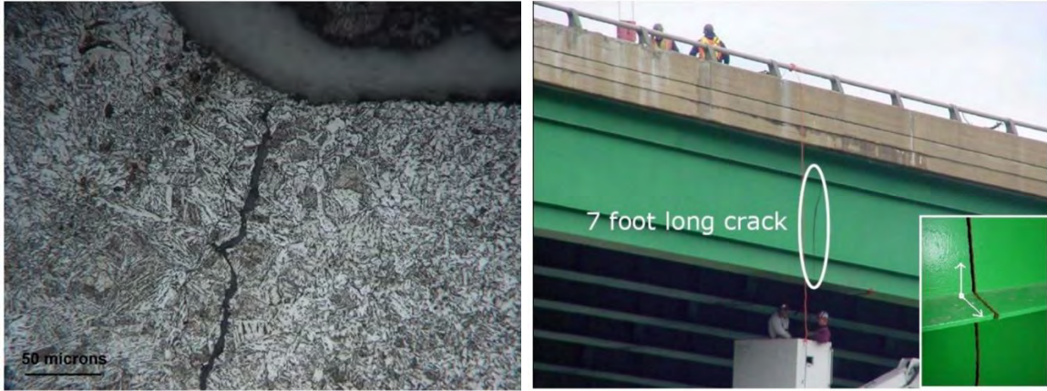
Fig. 182 Fenomene de fisurare în construcții metalice sudate [poduri de oțel].
