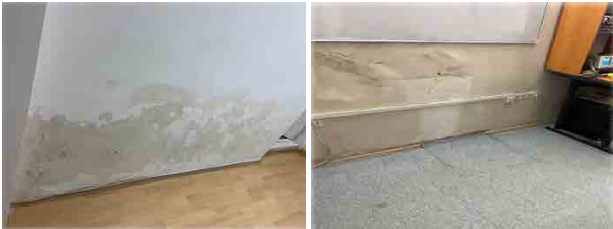
Figura 9. Gradul de degradare din interiorul clădirii.
