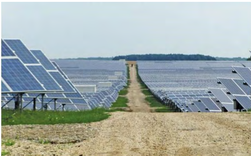
Figura.3 Parc fotovoltaic, jud.Satu Mare
