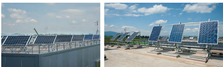
(b) Șiruri fotovoltaice cu sisteme monoaxiale de orientare
