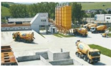
STATIE DE BETOANE
